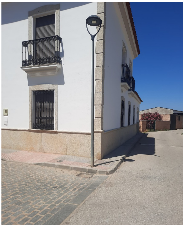
Foto: Acerados impracticables en urbanizaciones recientes.
